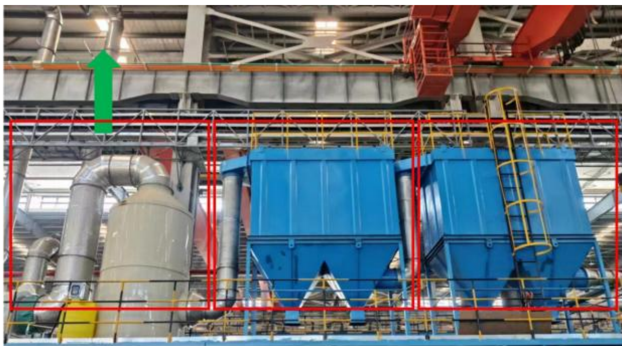
废气处理设备
